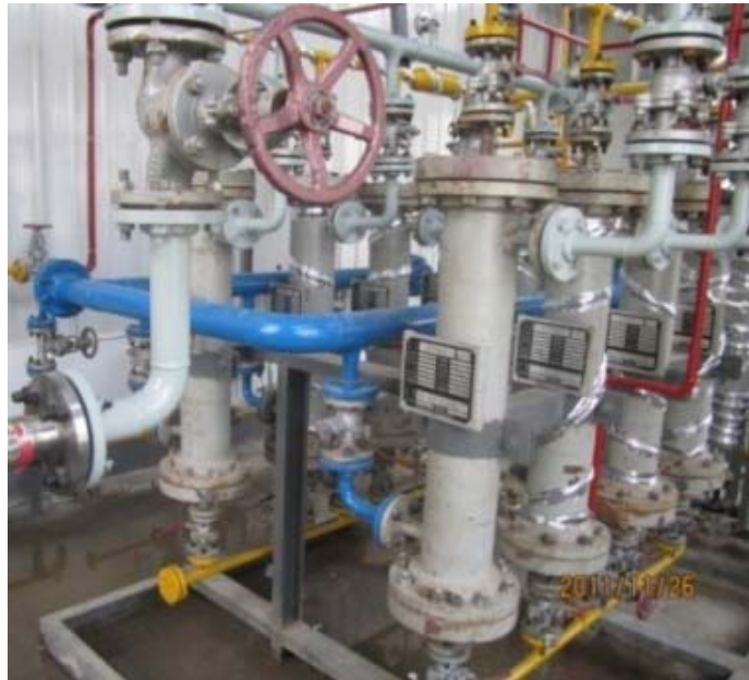
沼气脱CO 2 膜分离示范装置
