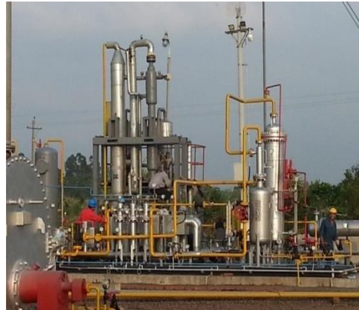
天然气脱CO 2 膜分离装置
